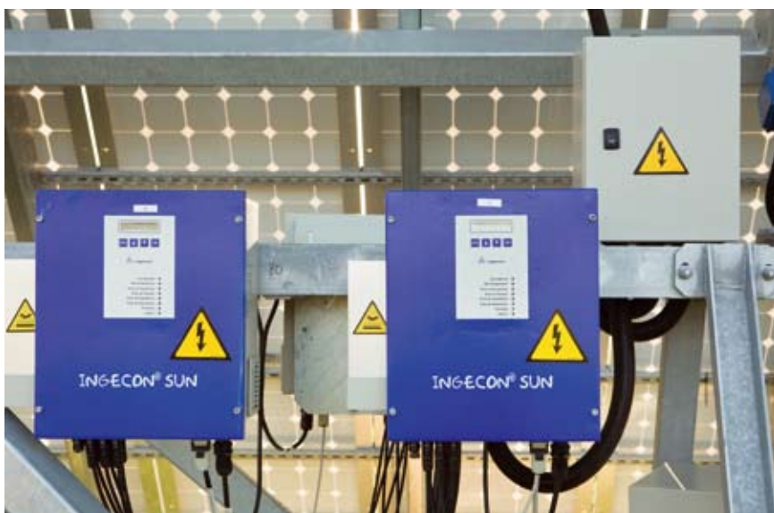
Cada seguidor cuenta con tres inversores, aunque en esta imagen sólo se puedan ver dos. A cada inversor le corresponden 21 módulos.
