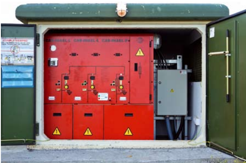
La compañía eléctrica Iberdrola Ingeniería y Construcción colocó en el parque cinco casetas como ésta para los transformadores. En una sexta caseta se une la tensión proveniente de estas cinco y se inyecta a la red.
